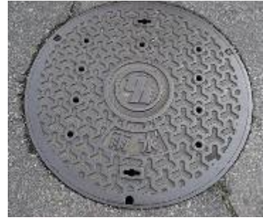
柏市の雨水幹線マンホール
